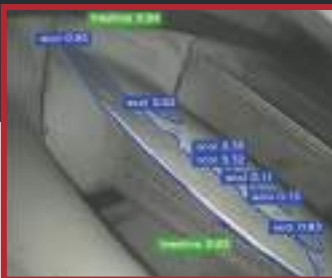
Детекция трещин и сколов
